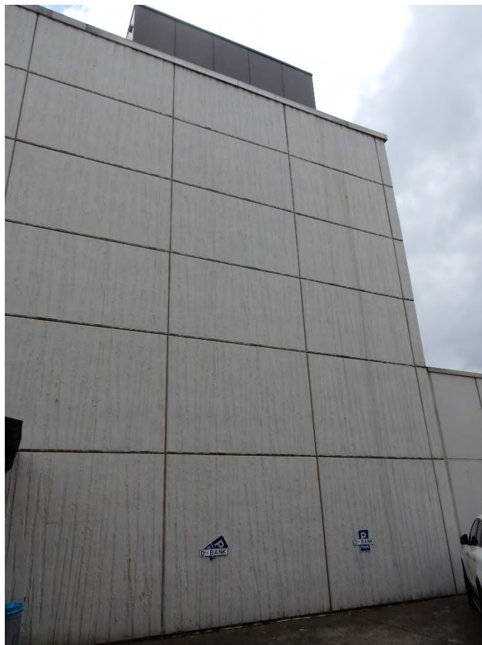
Foto 4 Die Fassade besteht aus Beton ohne Verkleidungen, lediglich im Bereich des Flachdachs ist eine umlaufende, überhän- gende Struktur, die für Fledermäuse interes- sant sein könnte.
